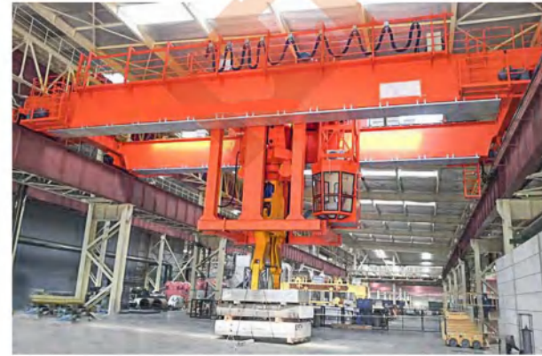
夹钳桥式起重机 Clamp bridge crane
